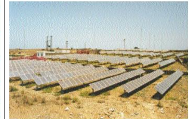
PV-System mit 100 kWp
